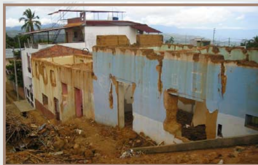
Fig. 4. Vivienda destruída en terremoto de Lamas (setiembre 2005).
