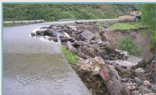
Fig. 16. Pérdida de capa asfáltica por diseño y mantenimiento inadecuados en ruta Jaén - Moyobamba.
