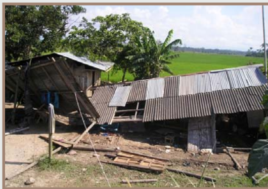
Fig. 10. Viviendas construidas sin tecnología sismoresistente y destruidas por terremoto.
