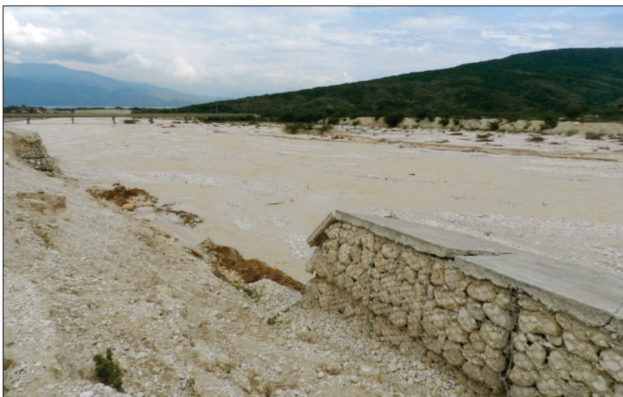
Rio Soliette-Blanco en Jimaní, después del paso de la tormenta tropical Sandy derribó el muro de gaviones construido para evitar desbordamientos (Jimaní, 22 de noviembre 2012. Fotografía: Raquel Casares)
